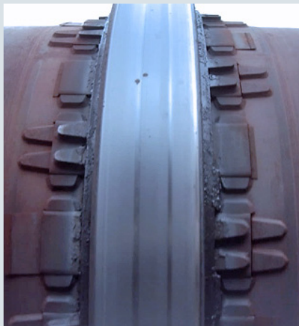
Laufringbefestigung im Betrieb
